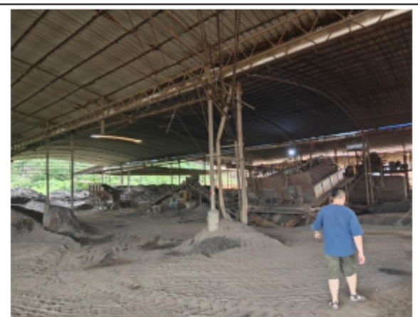
项目破碎筛分车间
